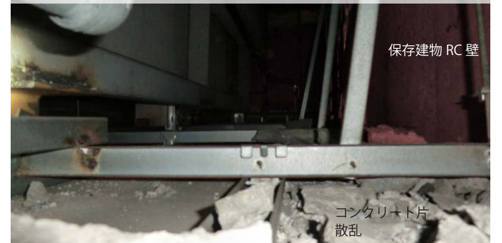
F 鉄骨梁と保存建物の接合部欠損、保存側壁上部鉄筋露出
